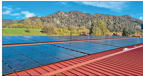
Die neue PV-Anlage von Halton in Reit im Winkel mit einer Fläche von 520 Quadratmetern umfasst an die 250 Module und erzeugt eine Leistung von 100 kWp. – Foto: Halton
