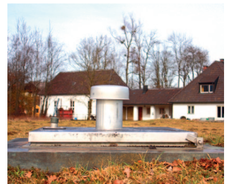
Klein und unscheinbar siebt der Brunnen in Aumühle an der Oberfläche aus und doch versorgt er mehr als 5.000 Überseer mit hochwertigem Trinkwasser - im Hintergrund rechts die Büros des Wasserbeschaffungsverbandes und links das Kraftwerk
